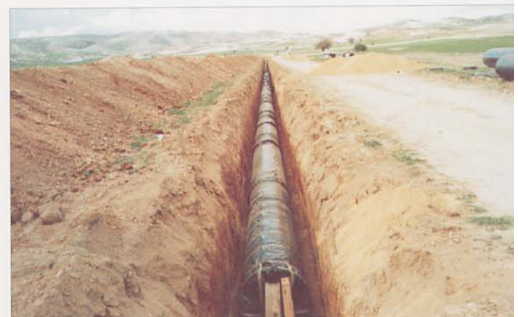
Αγωγός Τερσεφάνου - Λευκωσίας - Tersephanou - Nicosia conveyor
