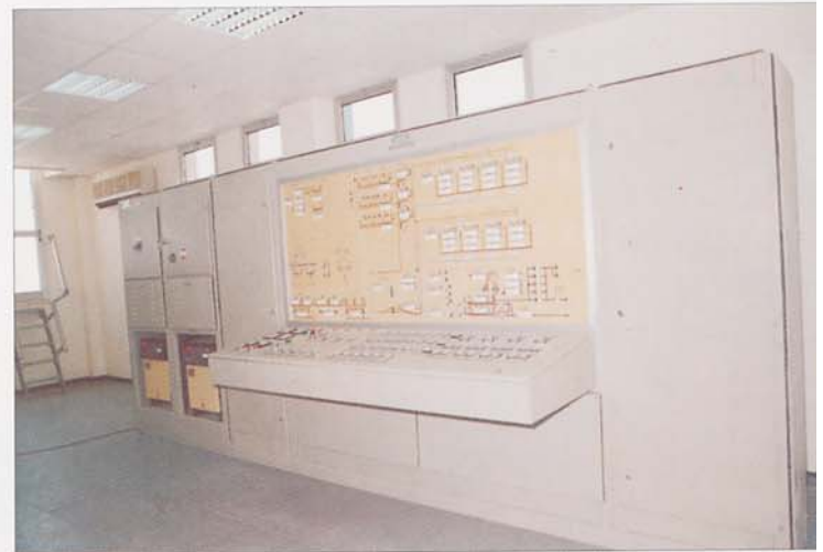
Κεντρικός πίνακας ελέγχου - Central control panel
