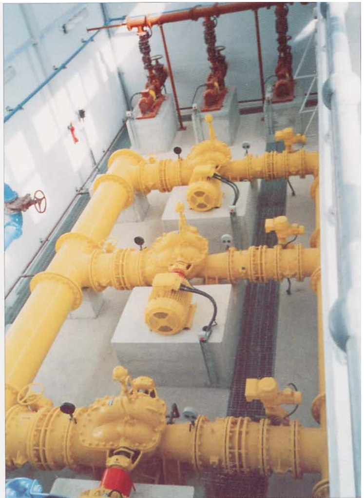
Βοηθητικό αντλιοστάσιο - Service pumping station
