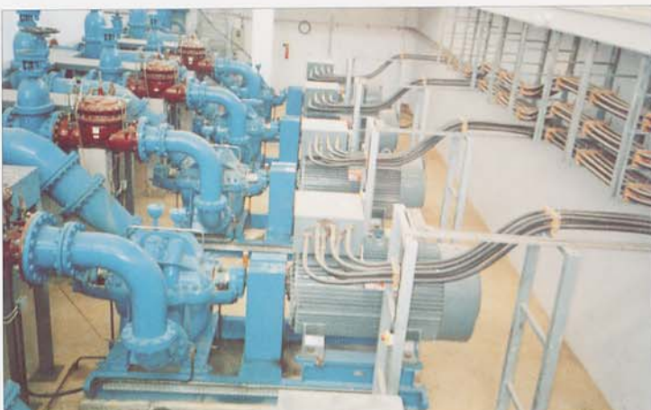
Αντλιοστάσιο Τερσεφάνου - Tersephanou pumping station
