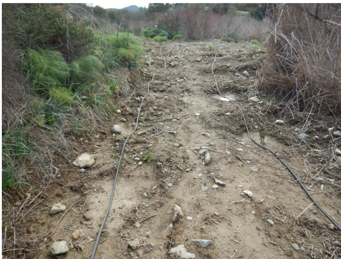
Εικόνα 2: Άποψη ποταμού ανάντη αγροτικού δρόμου, πριν και μετά τα έργα υδρομορφολογικής αποκατάστασης- Τμήμα 1 (Φώτο: I.A.CO Ltd).
