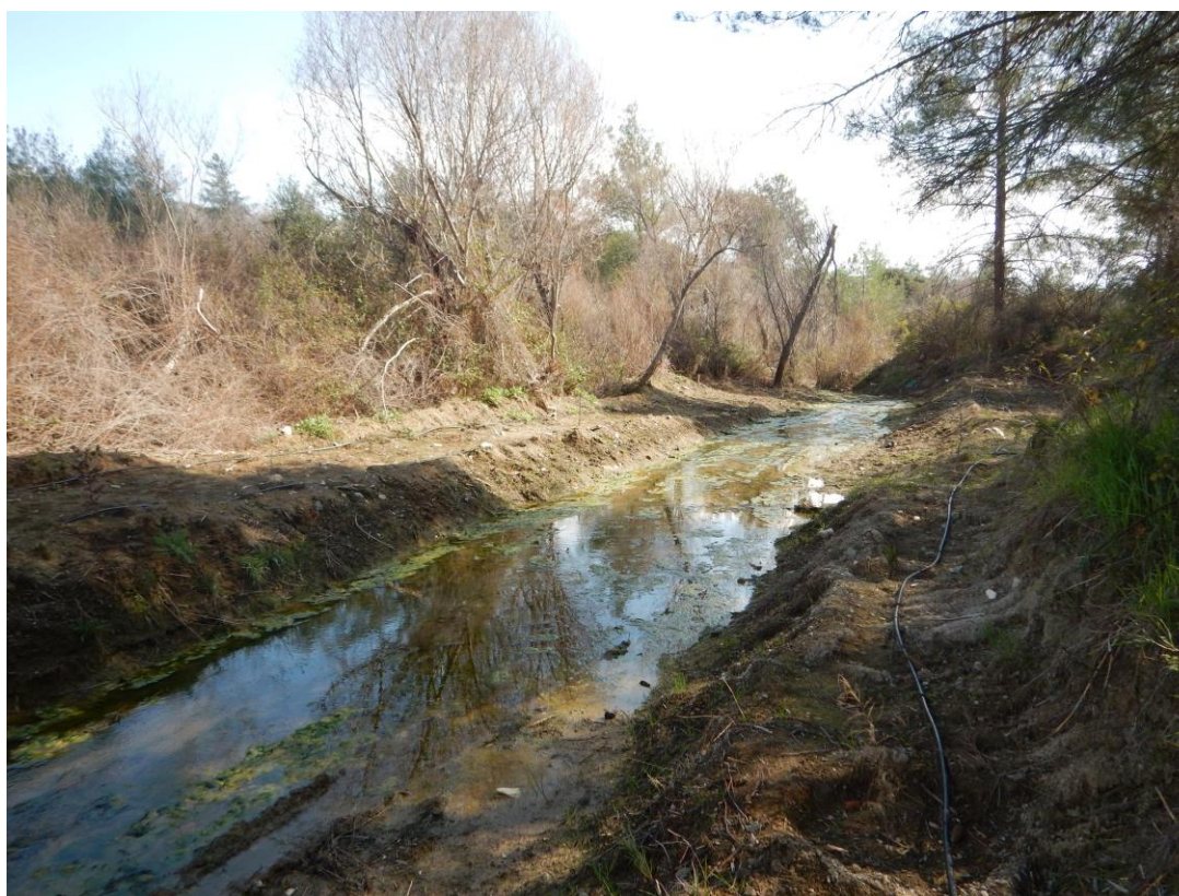
Εικόνα 5: Άποψη ποταμού κατάντη αγροτικού δρόμου, πριν και μετά τα έργα υδρομορφολογικής αποκατάστασης- Τμήμα 2 (Φώτο: I.A.CO Ltd).
