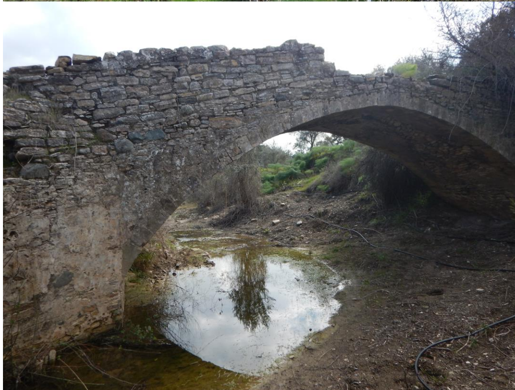
Εικόνα 1: Άποψη γεφυριού πριν και μετά τα έργα υδρομορφολογικής αποκατάστασης- Τμήμα 1 (Φώτο: I.A.CO Ltd).
