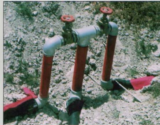
Εξαρτήματα και σωλήνες με κατάλληλη σήμανση, που χρησιμοποιούνται για την άρδευση με ανακυκλωμένο νερό
