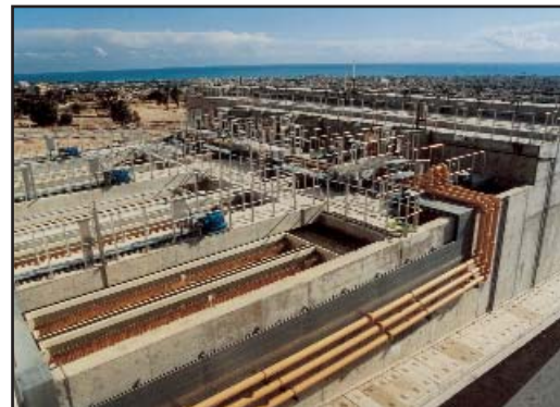
Διυλιστήριο Νερού στη Λεμεσό
