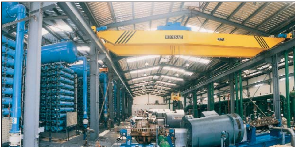
Μονάδα Αφαλάτωσης Λάρνακας
