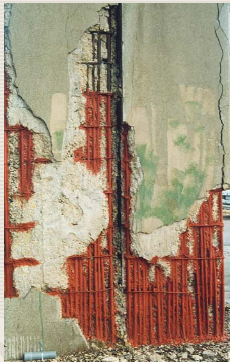
Κατακόρυφες ρηγματώσεις υποστυλωμάτων λόγω διευρυμένης οξείδωσης των οπλισμών
