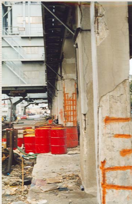
Γενικευμένες οξειδώσεις οπλισμών των υποστυλωμάτων
