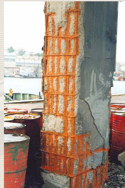
Λεπτομέρεια υποστυλώματος: Οξείδωση των οπλισμών – απομείωση της διατομής του οπλισμού
